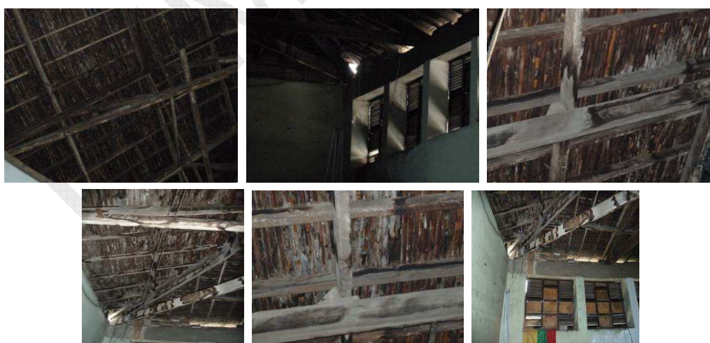
Foto 8. Estructura de cubierta y la estructura con huellas de humedades
