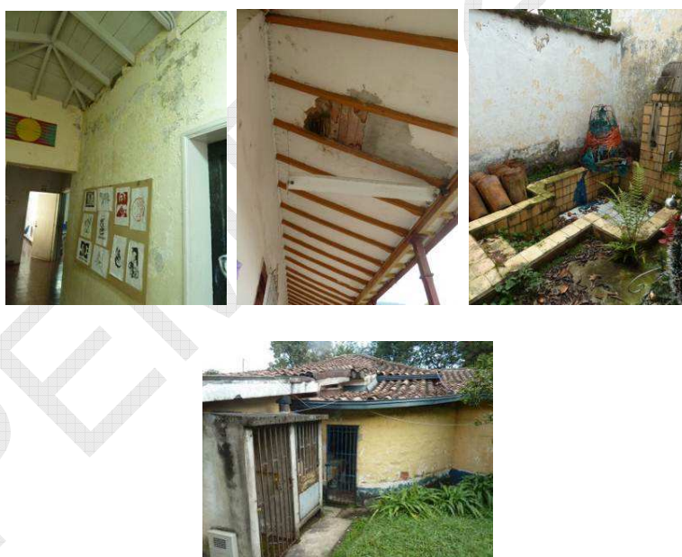
Foto 3. Detalles del deterioro en algunos BIC
