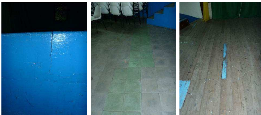
Foto 9. Fisuras en escenario, intervención en piso
